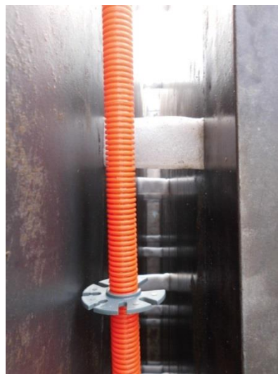
Figura 10 – Espaçador plástico fixado ao eletroduto
