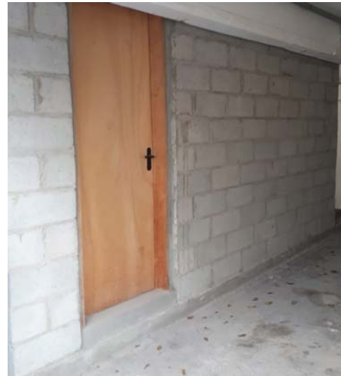
Face sem revestimento
