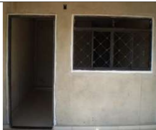
Figura 34 – Faixa de emulsão acrílica na interface da face externa do painel e perímetro das esquadrias.
