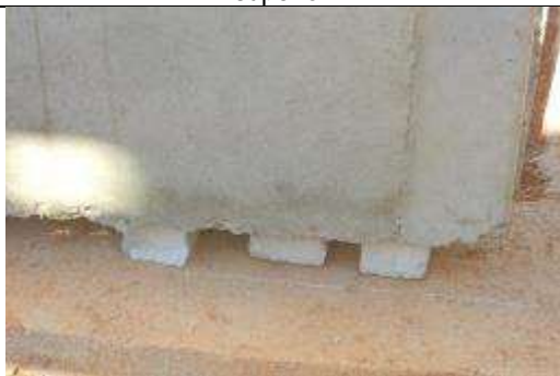
Figura 25 – Painel apoiado em calços de argamassa.
