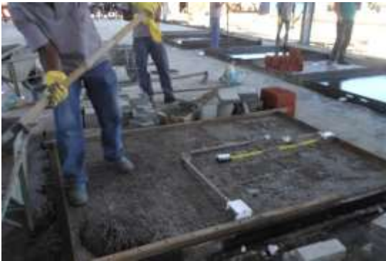
Figura 12 – Posicionamento das tubulações hidráulicas e lançamento da terceira camada de concreto ( f_{ck} 10MPa) em painel de parede hidráulica.
