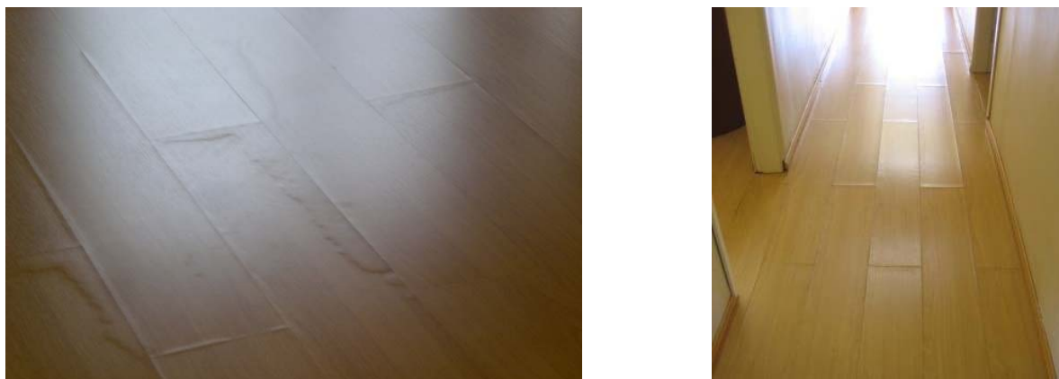
Figura 7 – Pisos laminados instalados danificados por inchamento.
